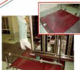
総合病院厨房 ●厨房入室時(下膳時)汚染物及び汚染空気 の厨房への持込を防止する為、自動ドアが開いた 際、空間及び車輪にカンファ水を噴霧
